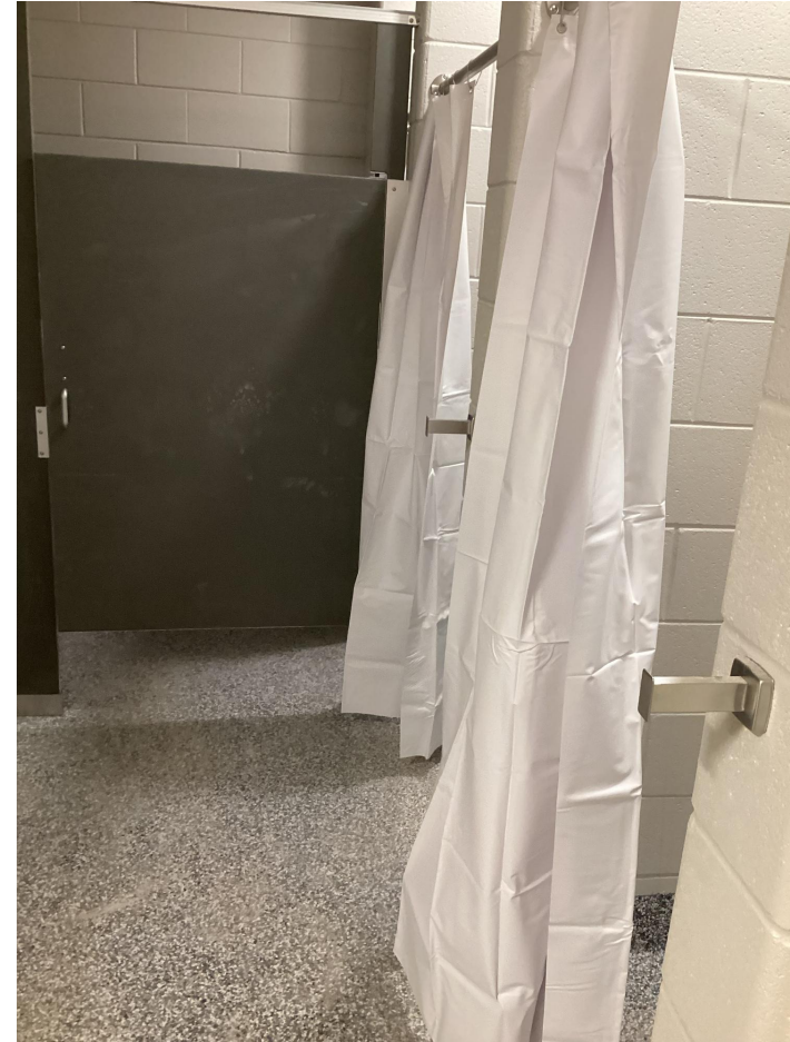
Duchas en los baños
