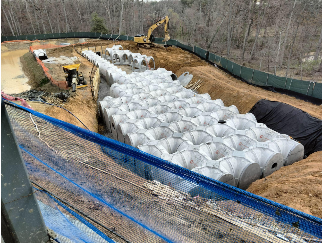
Système de gestion des eaux pluviales
