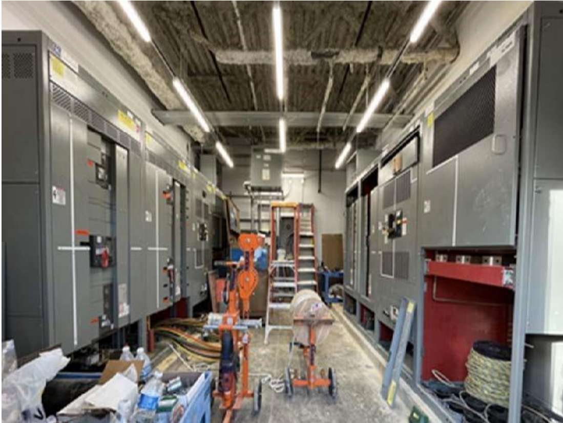
Salle électrique principale - Appareillage de commutation
